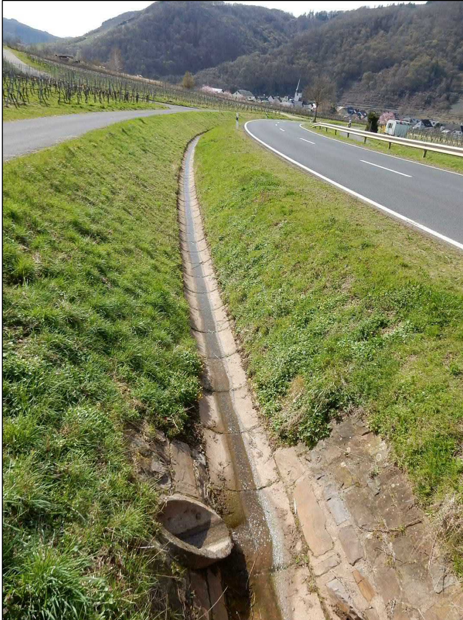
Abbildung 15: Betonrinne an einem Hang der VG Cochem zum Ableiten des Niederschlagswasser (Foto: Enviro-Plan GmbH)
